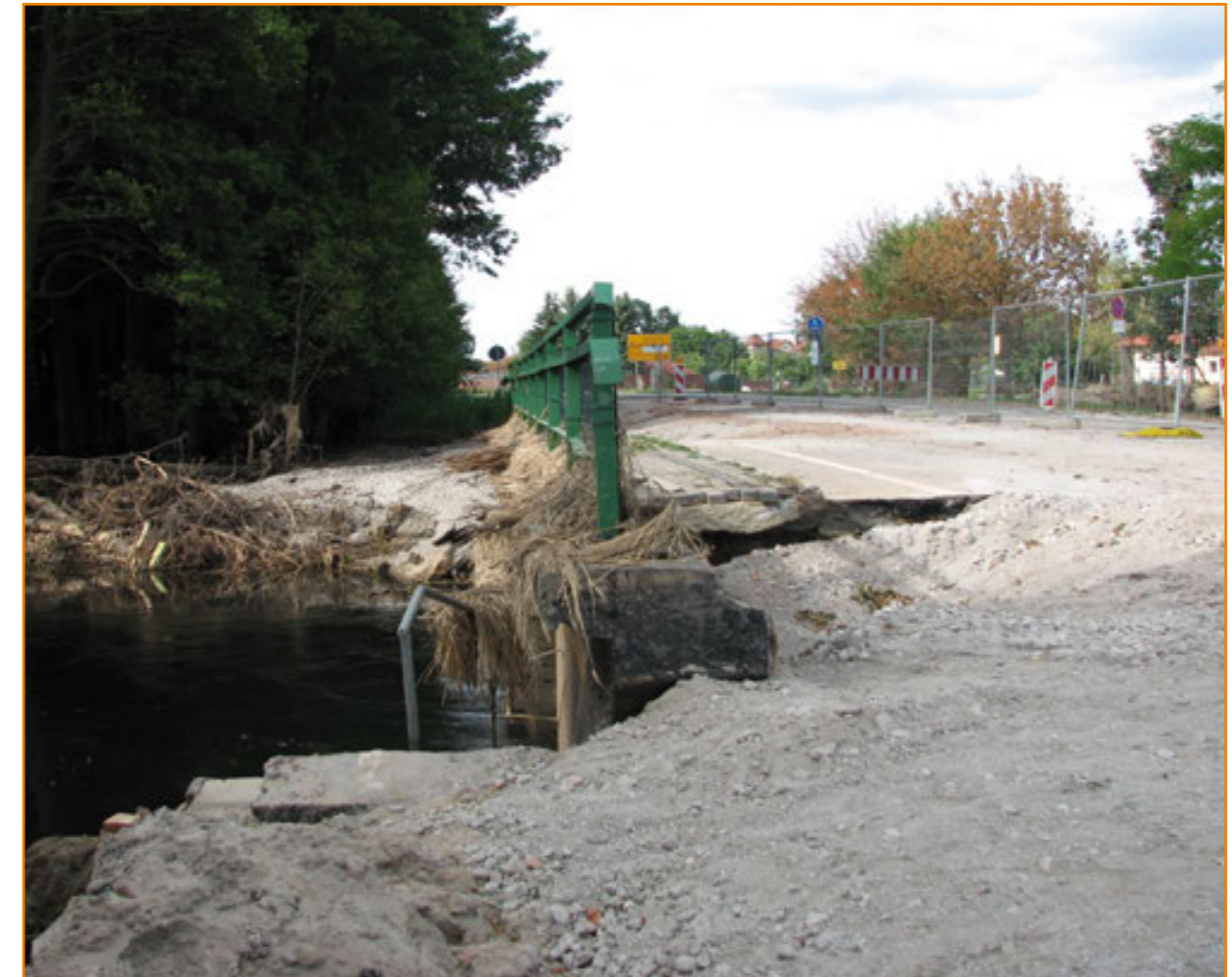
Die zerstörte Brücke an der B 107 in Kliez.
